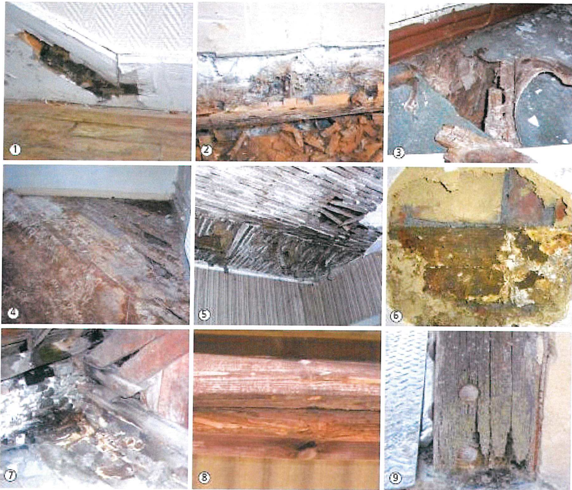
Dégâts occasionnés par le champignon à pourriture cubique Source Anah – Prévention et lutte contre les mérules dans l'habitat - 2006
